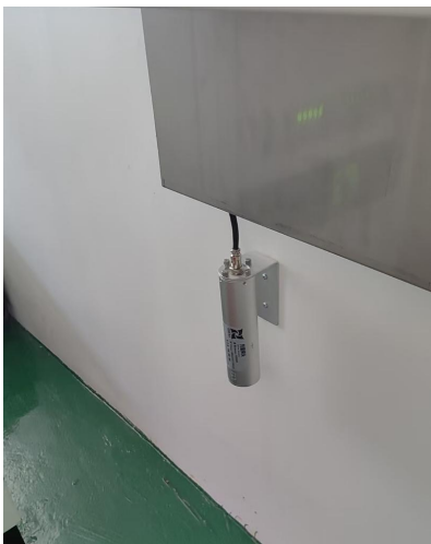
电气室内固定式剂量探头
