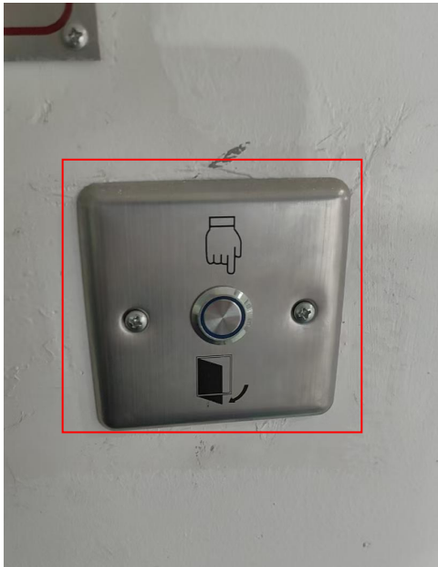
辐照室迷道进口紧急开门装置
