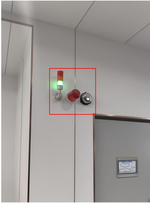
辐照室迷道外警灯、警铃、三色灯
