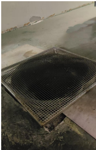
辐照室内出风口
