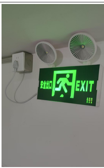
辐照室内紧急出口指示灯
