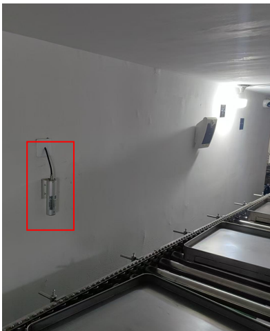
辐照室内处固定式剂量探头
