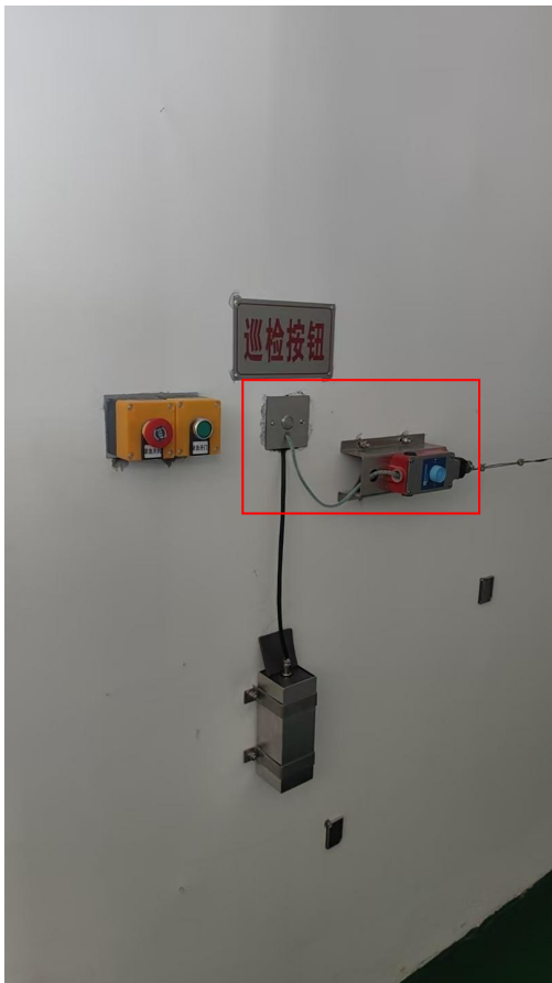
主机室进口处巡检按钮、巡检拉线开关
