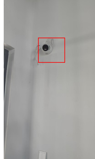
控制室通道监控探头
