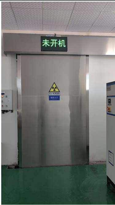
主机室防护门处电离辐射标志
