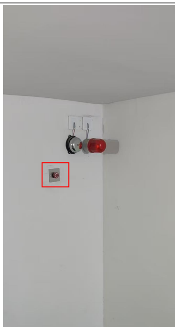
辐照室内急停按钮
