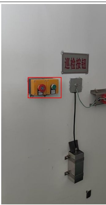
主机室入口处急停按钮
