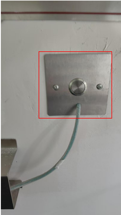
辐照室进口处巡检按钮
